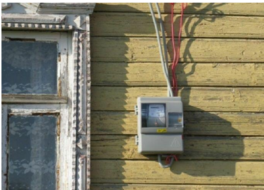
Рисунок 2: Счётчик в защитном кожухе на фасаде дома
